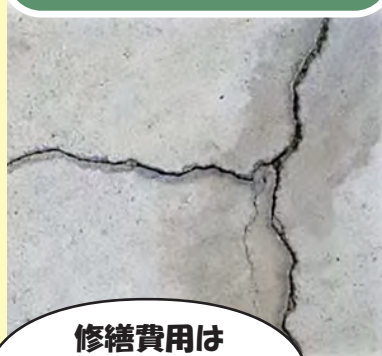
コンクリート外壁の欠落
