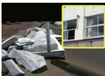
外壁（モルタル）が落下
