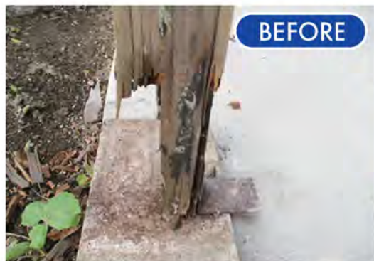
腐朽劣化した柱(柱下部がほとんど損失)
