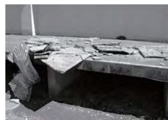
外壁（ラスモルタル） 約 100kg が落下
