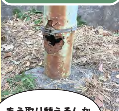
屋外柱の老朽化
