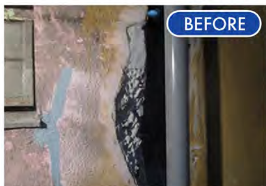
爆裂進行したコンクリート壁
