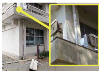
校舎2階バルコニー手すりが 落下：生徒が落下し負傷
