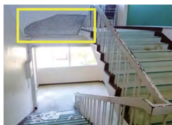
天井（階段裏）のモルタル 約 80kg が落下
