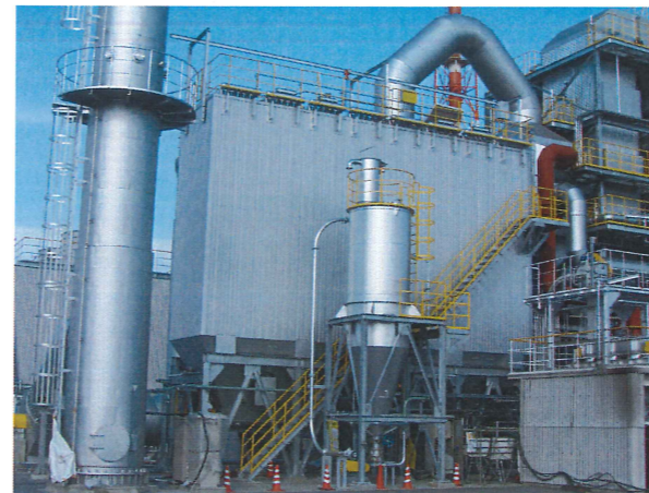
ボイラ集塵設備 (UPL-504-20 型)
